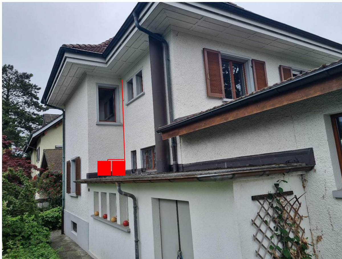
Fotos Aussengeräte (Vordach) Birkenweg 6, 5032 Aarau Rohr
